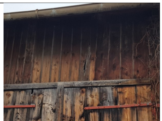
Abb. 3 Spalten in der Fassade Fl.St. 857/1
